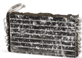
Sin mantenimiento del sistema de A/A
